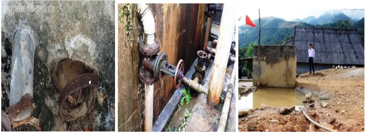
Hình 4. Một số hư hỏng công trình cấp nước (Nguồn: Sổ Tay hạ tầng nông thôn - Bộ NN&PTNT)
