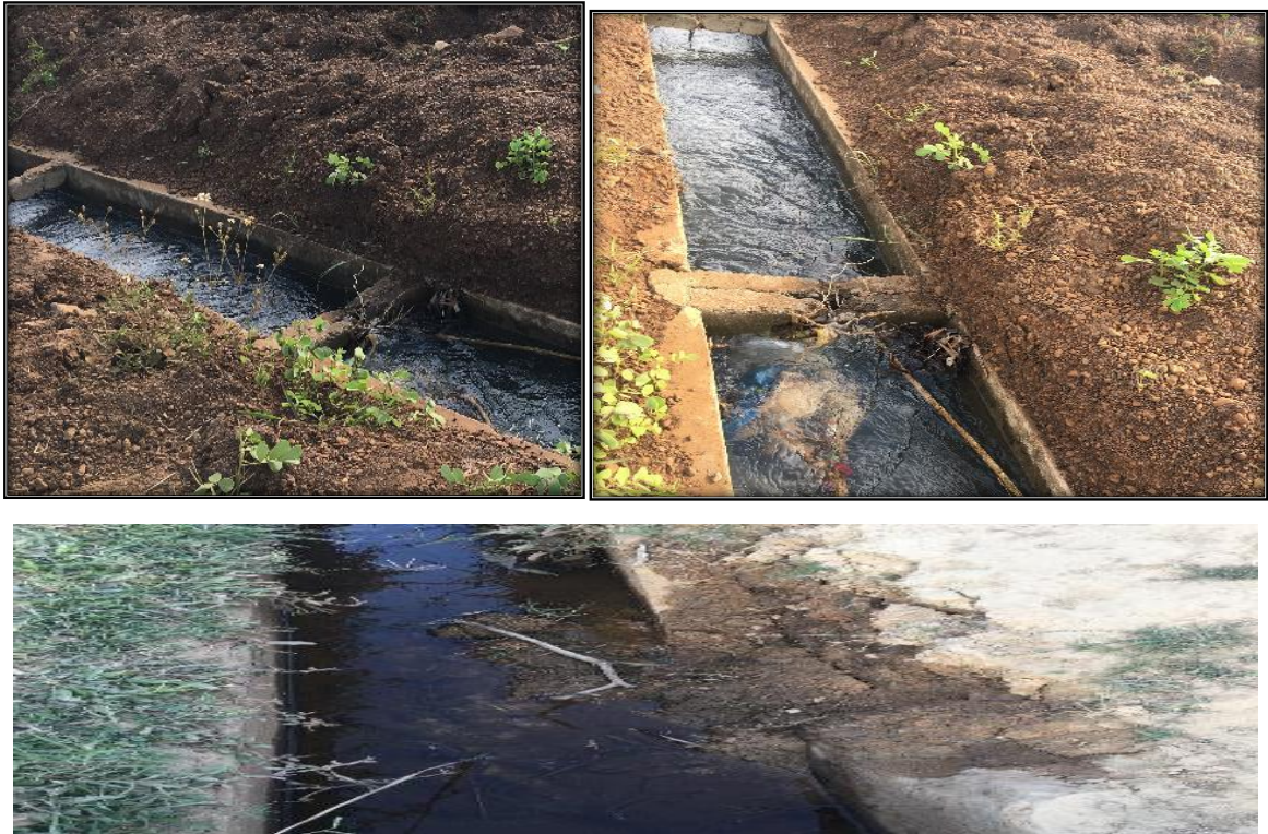
Hình 3. Gãy vỡ kết cấu kênh tưới
